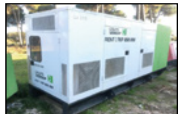
2009 Olympian GEP500 500KvA
